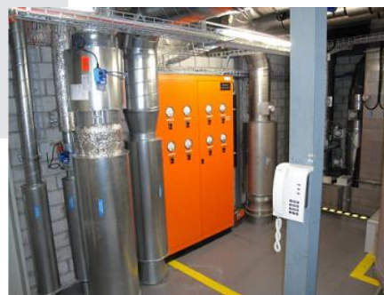
Technikzentrale Sicherheitsbereich B3
